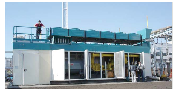
Блочная компрессорная установка
