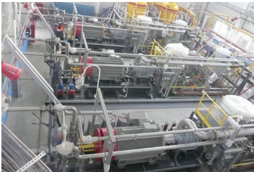
Фото 3. ДКС Enerproject на открытой раме (Рогожниковское м-р)
