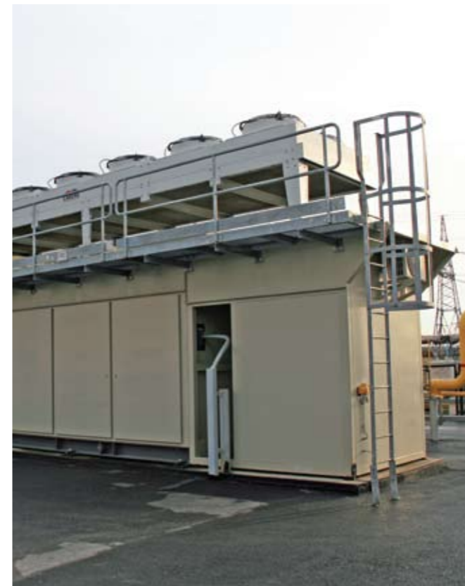
Фото 3. Блочная КУ на Уфимской ТЭЦ-1 («Башкирэнерго»)
