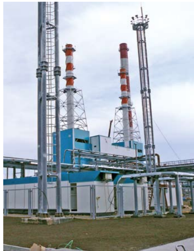
Фото 2. ДКУ Enerproject на Белгородской ТЭЦ
