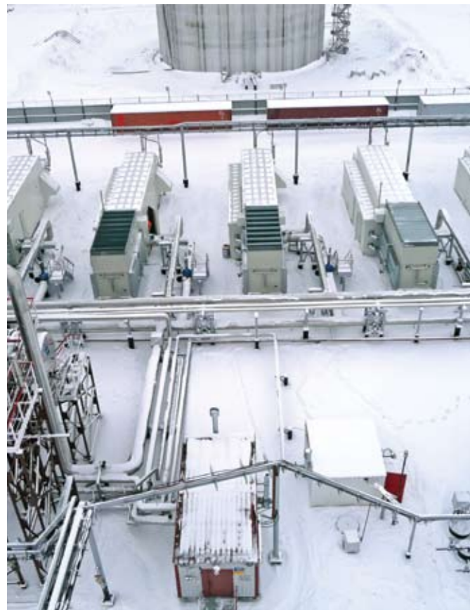
Фото 1. Компрессорная станция АLEXинского месторождения (ОАО «Сургутнефтегаз»)
