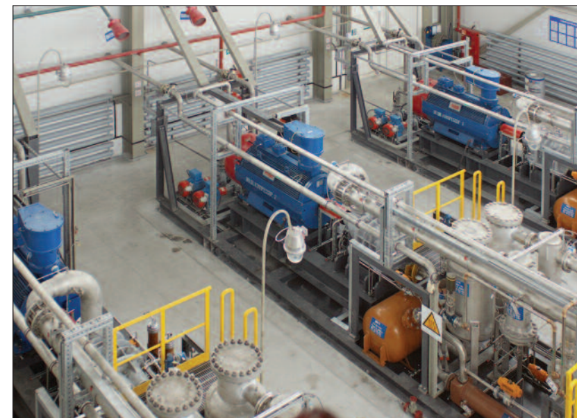
Фото. Дожимные компрессорные установки ENERPROJECT на Конитлорском месторождении
