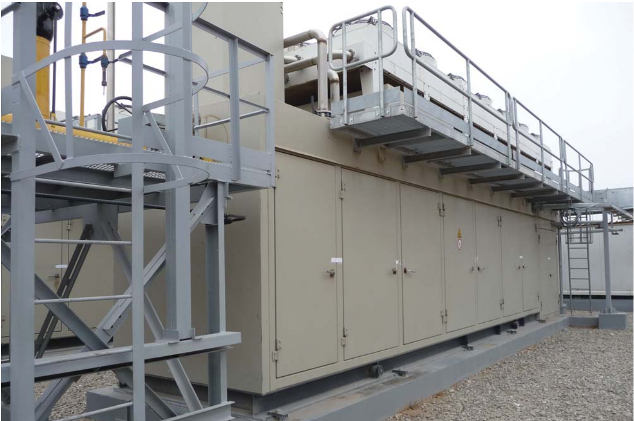
Дожимная компрессорная станция на ПГУ-110 в эксплуатации.
