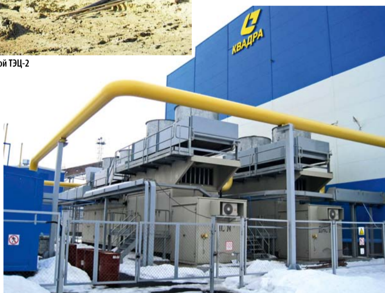
Дожимные компрессорные установки в эксплуатации
