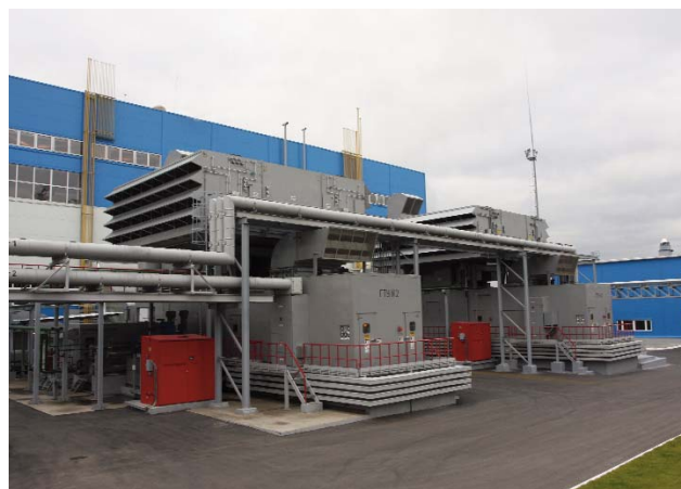
Фото 2. Блочно-модульные газотурбинные установки LM6000PD Sprint производства General Electric
