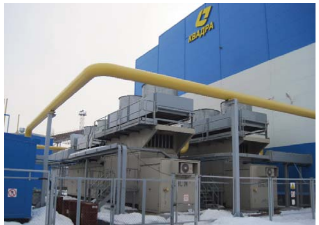
Фото 4. Дожимные компрессорные установки в эксплуатации
