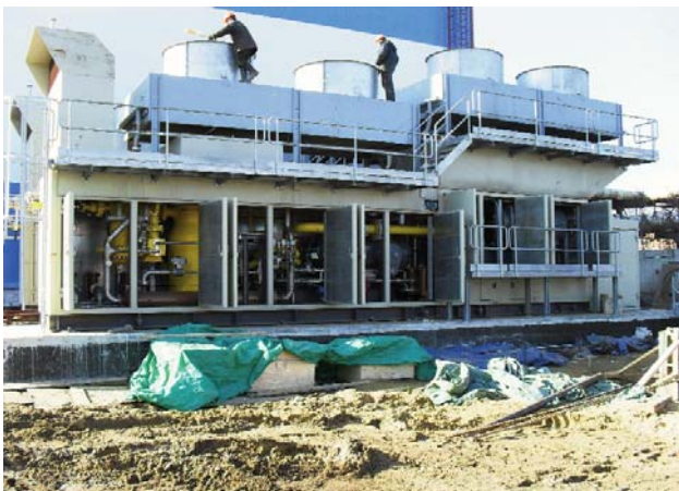
Фото 3. Шефмонтаж ДКУ ENERPROJECT серии EGSIS-300/1000-100/1000 WA
