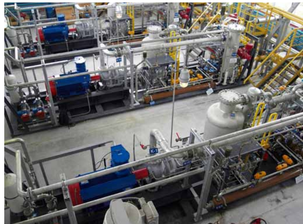
■ ДКУ ENERPROJECT на открытой раме (Конитлорское месторождение)
