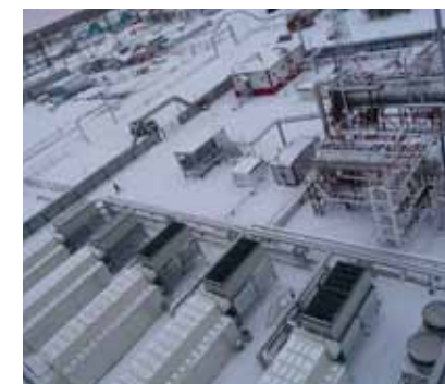
■ Газодожимная компрессорная станция Алёхинского месторождения
