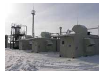
■ Компрессорная станция на НГДУ «Комсомольскнефть»
