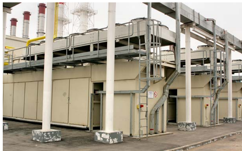
Блочное исполнение станции позволило разместить оборудование на крайне ограниченной территории
