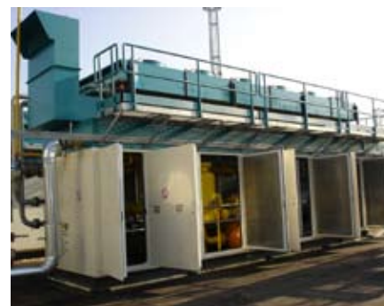
Фото 2. ДКУ Enerproject в блочно-модульном исполнении
