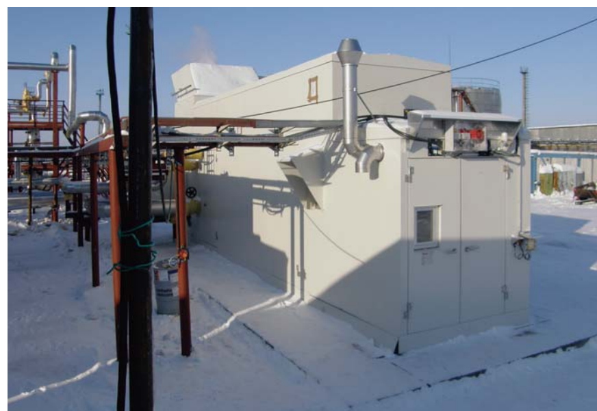
Фото 2. Блочно-модульная ДКУ (Быстринское месторождение)
