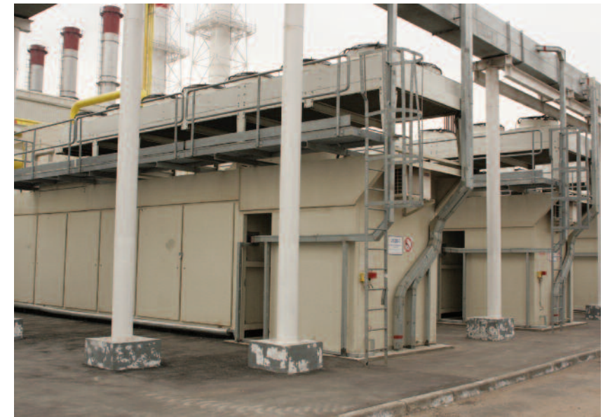
Фото 2. Блочно-модульные установки Enerproject («Москва-Сити»)
